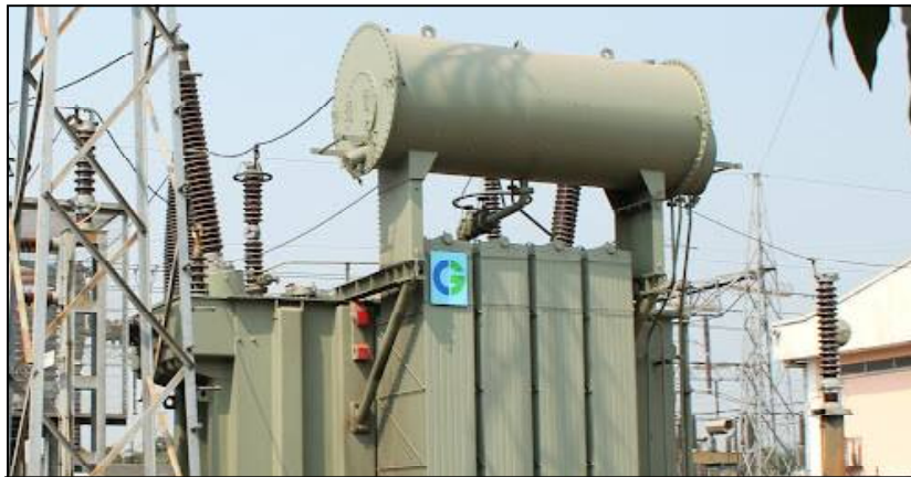
Transformateur de la Snel au poste de distribution du courant électrique à Bandalungwa. PH. JOHN BOMPENGO/ RADIO OKAPI
